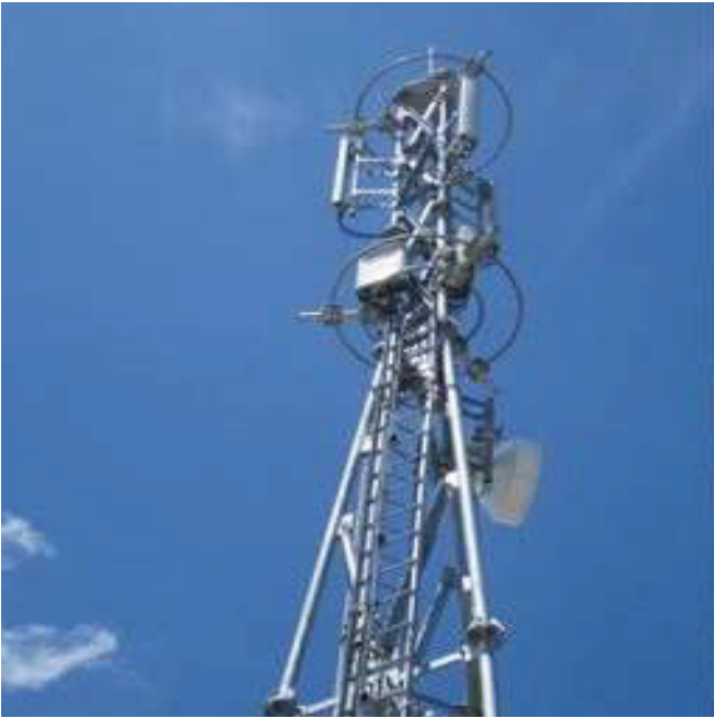
DỰ ÁN : TRẠM BTS - MOBIFONE
