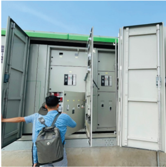
CÔNG TRÌNH TBA TRẠM SẠC TÂY NINH BÌNH
