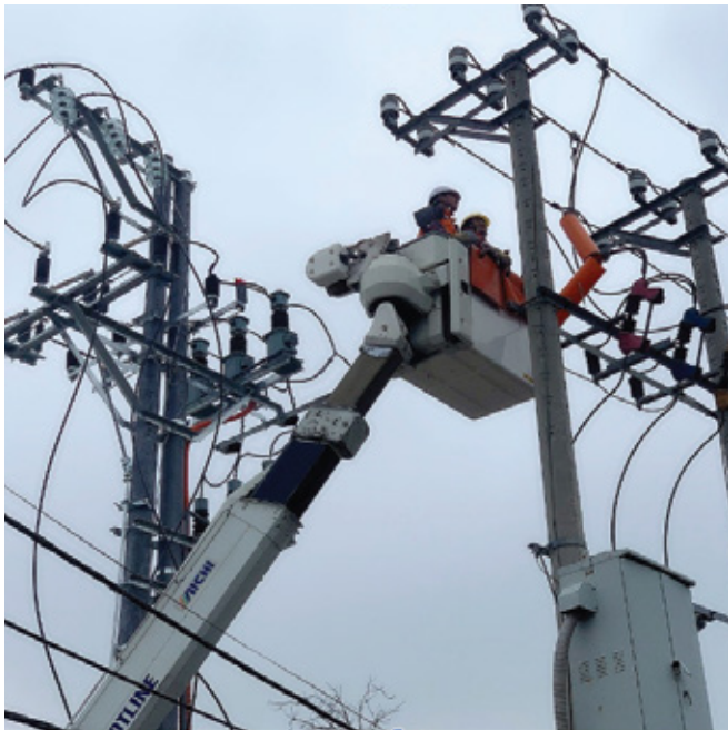
CÔNG TRÌNH TBA TRẠM SẠC CHXD NGHĨA HƯNG
